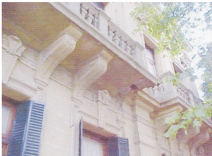
Detalle de los balcones. Se observa la pérdida de balaustres y ménsulas.
